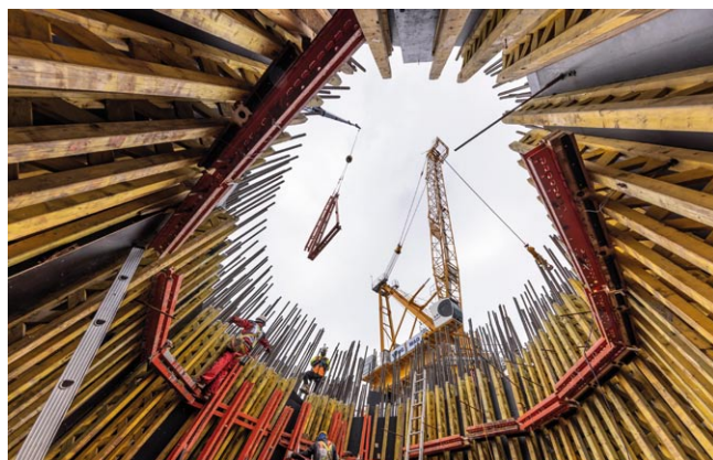
Deskowanie dźwigarowe VARIO GT 24 stanowiło idealną podstawę dla każdej sekcji konstrukcyjnej pylonu; w razie potrzeby można go połączyć z innymi systemami deskowań PERI
