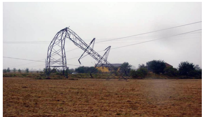
Rys. 4. Zniszczenia elementów sieci energetycznej powstałe w wyniku silnych wiatrów
