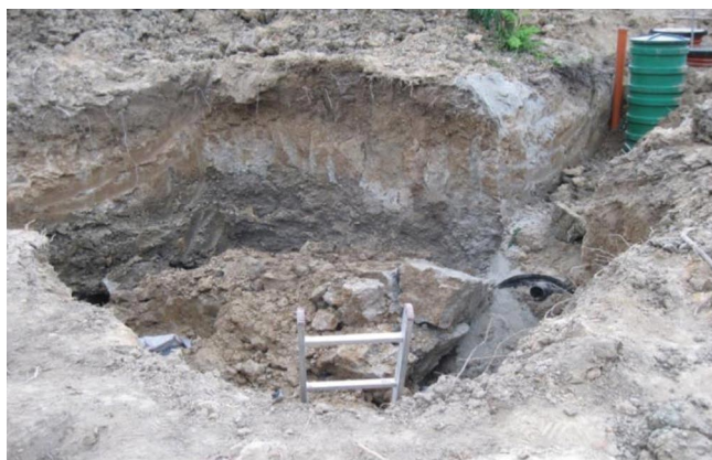
Rys. 8. Widok ogólny miejsca wypadku, wraz z widocznym gruntem, który się osunął (źródło: archiwum PIP)
