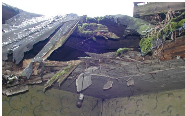
Rys. 1. Fragment zawalonego dachu budynku
