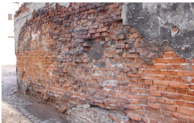
Rys. 3. Przykład destrukcji cegieł w dolnej części ściany
