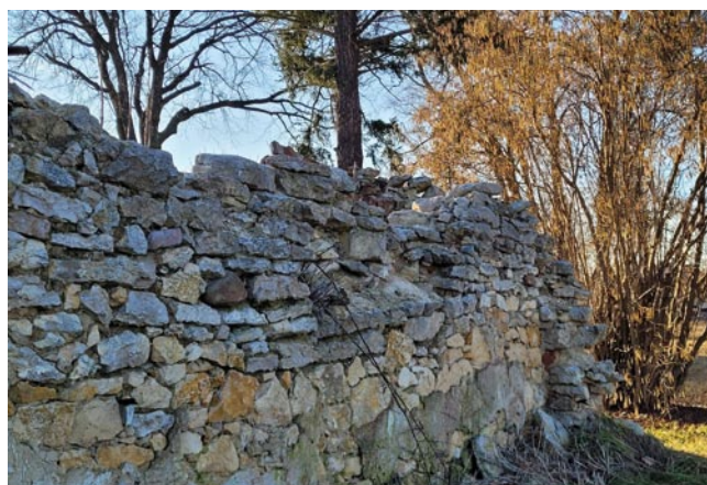
Rys. 9. Rozluźnienia struktury ścian
