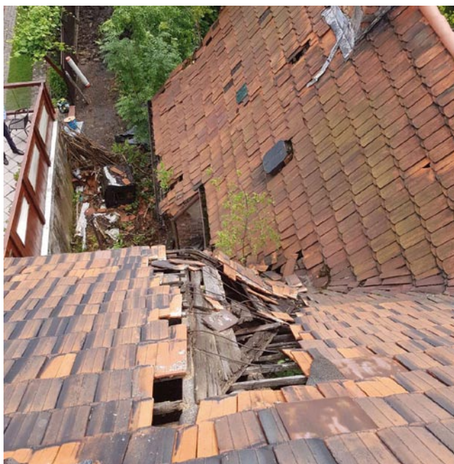
Rys. 5. Przykład uszkodzeń w obrębie połaci dachu
