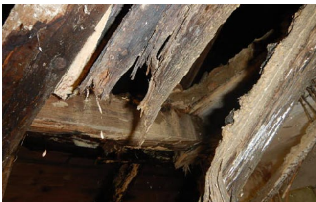
Rys. 7. Przykład stanu technicznego elementów więźby dachowej
