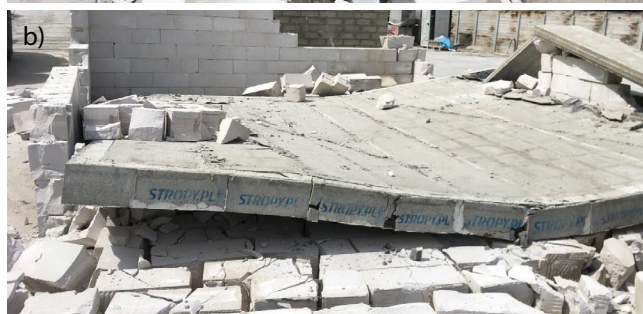
Rys. 10. Widok stropu po zniszczeniu
