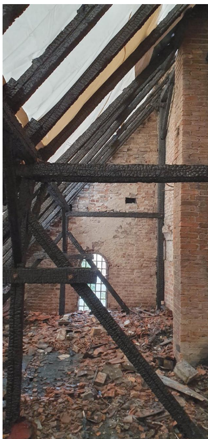
Rys. 4. Widok pogorzeliska oraz uszkodzonej pożarowo drewnianej konstrukcji zadachowania nad pomieszczeniem nad zakrystią w nawie bocznej kościoła pw. Świętych Apostołów Piotra i Pawła w Gdańsku
