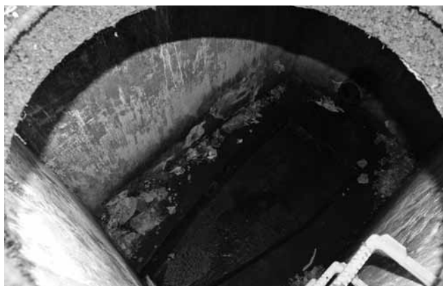
Rys. 1. Destrukcja napraw powierzchniowych komór rozprężnych (obiekty nr 1) w dwa lata po wykonaniu
