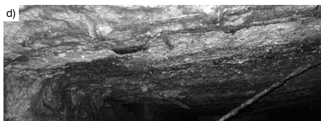
Rys. 2. Destrakcja kanałów ściekowych (obiekty nr 2) po 35 latach użytkowania: a) widok ogólny, b) destrukcja otuliny betonowej ścian i odsłonięte skorodowane zbrojenie, c) degradacja betonu stropu z odsłoniętym zbrojeniem, d) wyłamujące się samoczynnie zbrojenie stropu
