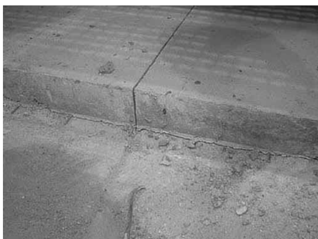
Rys. 3. Widok fragmentu nadbetonu
