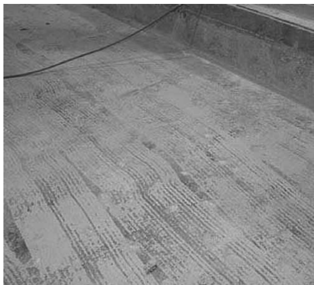
Rys. 1. Widoczne zapylenie podłoża po frezowaniu i niedokładne usunięcie warstwy utwardzenia powierzchniowego
