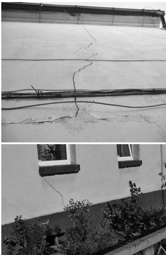
Rys. 9. Pęknięcia na ścianie zewnętrznej zachodniej i wschodniej
