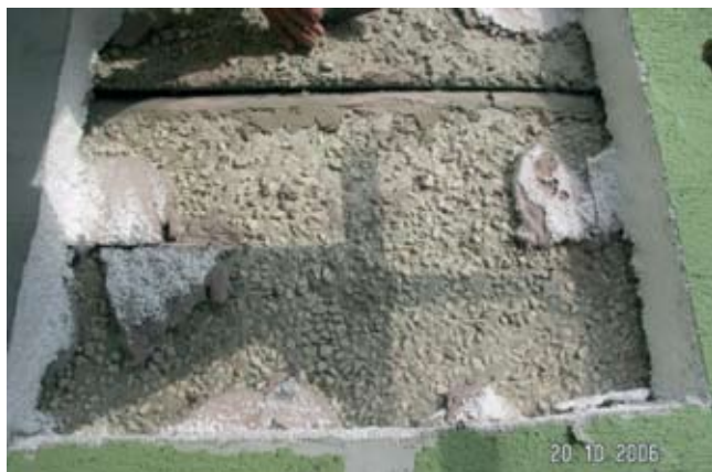
Rys. 6b. Odsonięcie warstwy docieplenia w obszarze złącza ZWO-ZWO-S
