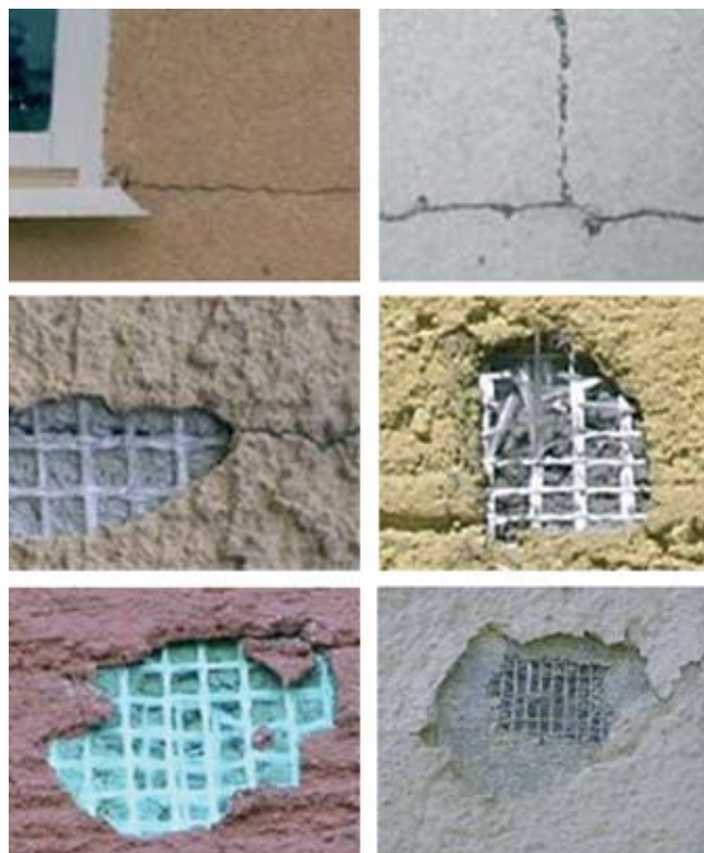
Rys. 14. Zarysowania i destrukcja wyprawy tynkarskiej i klejowej warstwy zbrojonej
