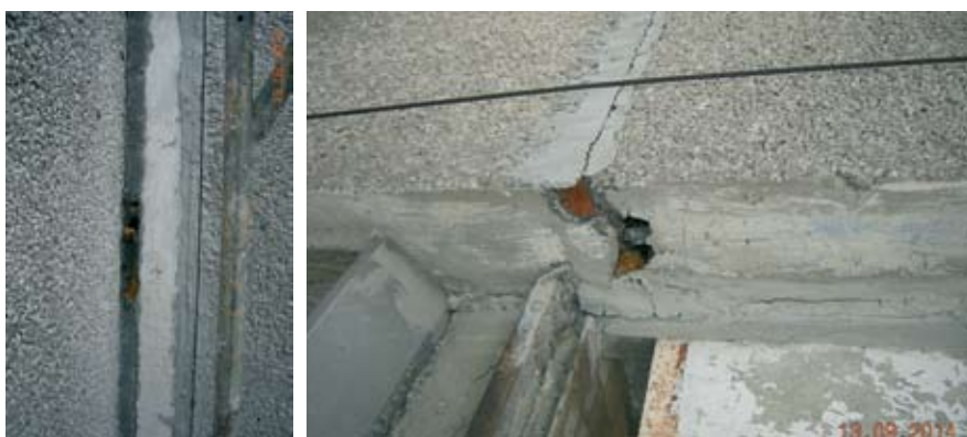
Rys. 8. Widok złączy systemowych – nieszczelności w miejscach przebiegu złącza
