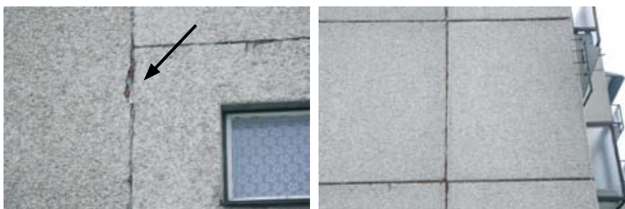
Rys. 5. Złącze systemowe w budynku nr 1 – widok od strony zewnętrznej
