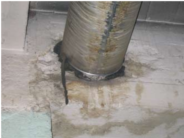
Rys. 3. Przebicie podciągu w strefie przypodporowej, widoczne ślady przecieku
