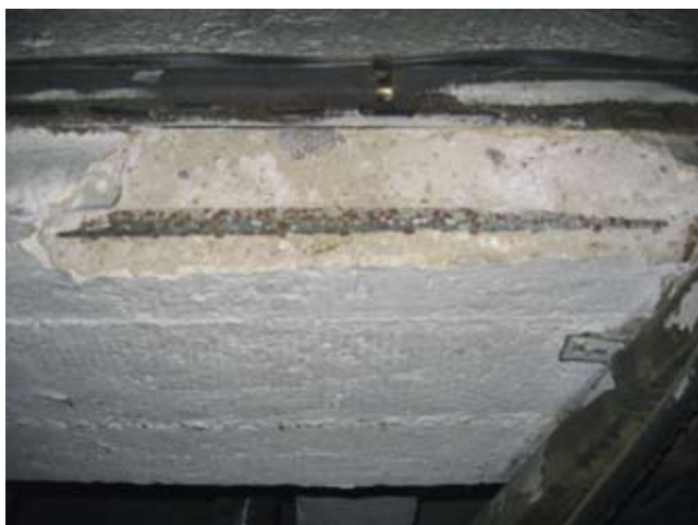
Rys. 2. Ubytek otuliny w podciągu, ślady wytrąconych soli, skorodowane zbrojenie
