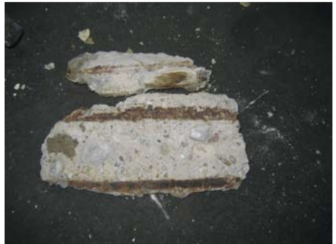
Rys. 4. Pobrane do badań próbki betonu ze śladami korozji
