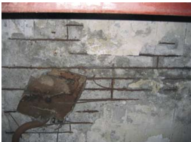
Rys. 1. Powierzchniowy ubytek otuliny w płycie, widoczne skorodowane pręty, zobjętniały beton
