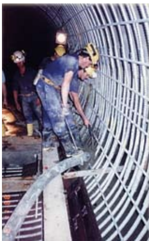
Rys. 11. Głębinyne oceaniczne wyloty kanałów ściekowych w Sydney zbrojone ocynkowanymi prętami [M4]
