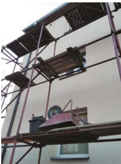
Niekompletne pomosty, brak balustrad, składowanie sprzętu na rusztowaniu
