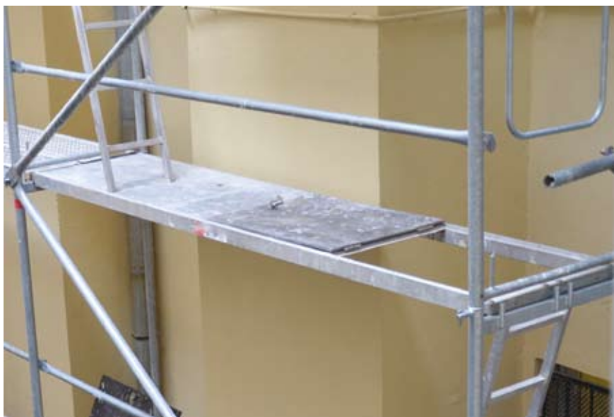
Brak desek burtowych oraz balustrady od strony wewnętrznej pomimo oddalenia od ściany przekraczającego 20 cm
