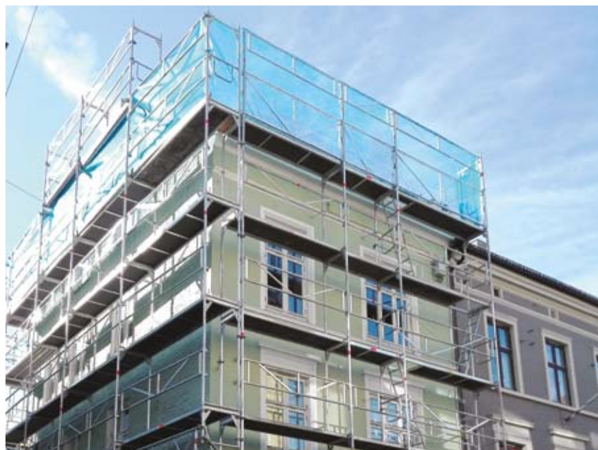
Brak desek burtowych oraz balustrady od czoła rusztowania
