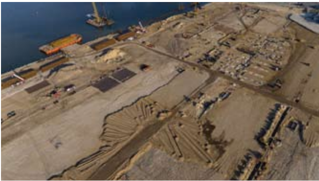
Rys. 12. Podnoszenie rzędnej terenu wraz z budową infrastruktury podziemnej wrzesień 2015 r. (źródło: zasoby NDI SA)
