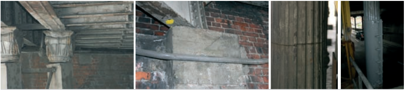
Rys. 4. Uszkodzenia konstrukcji podpór – pęknięcia i deformacje słupów i głowic filarów, pęknięcia ciosu podłożyskowego
