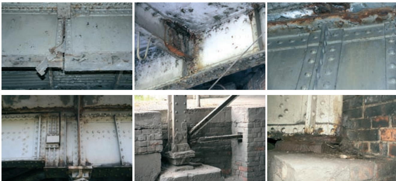
Rys. 3. Uszkodzenia konstrukcji przęseł – mechaniczne uszkodzenia dźwigarów w obrębie przegubu oraz korozja elementów pomostu, dźwigarów głównych oraz podpór
