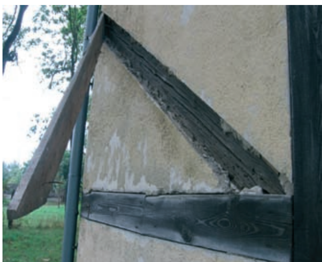
Rys. 4. Elewacja zachodnia. Odstońnięty drewniany zastrzał. Widoczna biologiczna korozja konstrukcji drewnianej
