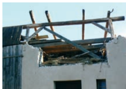
Rys. 8. Uszkodzenia dachu stodoły o spadku ~20 stopni, pokrytego papą
