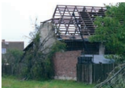
Rys. 7. Uszkodzenia dachu stodoły – dach spadzisty pokryty dachówką
