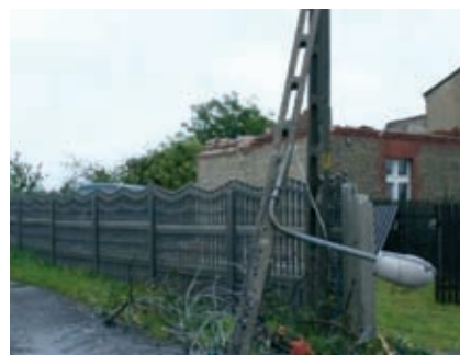
Rys. 12. Złamany słup linii elektrycznej
