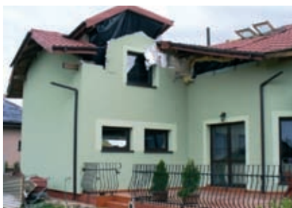
Rys. 14. Zniszczenie nowego budynku
