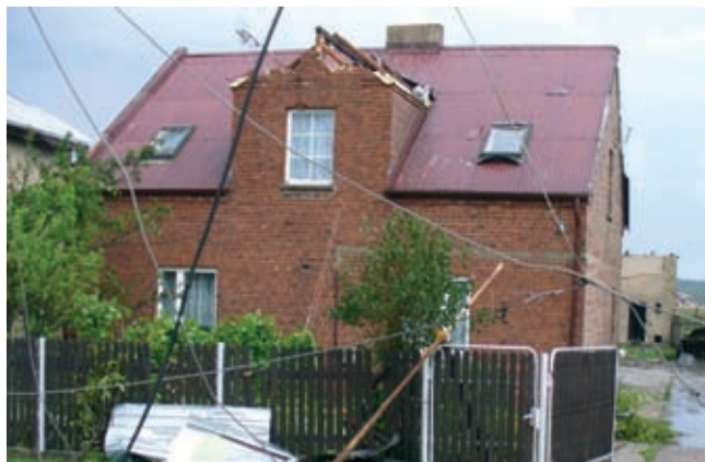
Rys. 6. Uszkodzenia dachu wielopołaciowego
