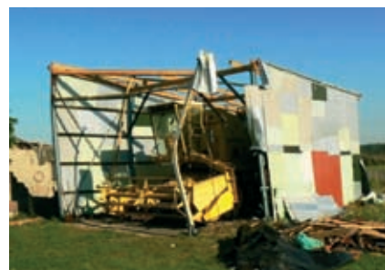
Rys. 9. Uszkodzona wiata na kombajnie
