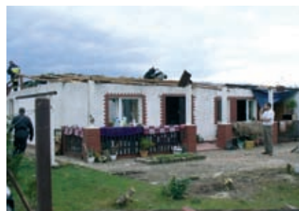
Rys. 15. Budynek mieszkalny z zerwanym płaskim dachem
