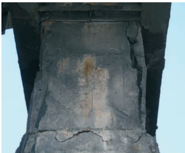
Rys. 4. Widok uszkodzeń betonu pod mocowaniem wsporników podtrzymujących konstrukcję obudowy taśmociągu
