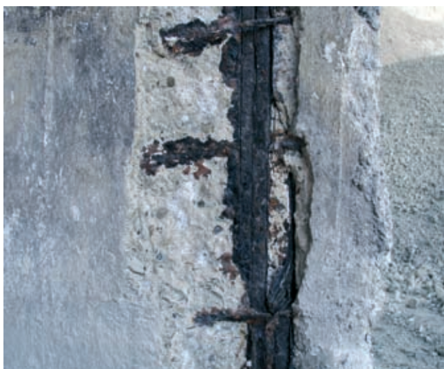
Rys. 5. Uszkodzenia słupa w składzie gipsu – widoczne pęknięcia i odspojenie otuliny, silna korozja zbrojenia
