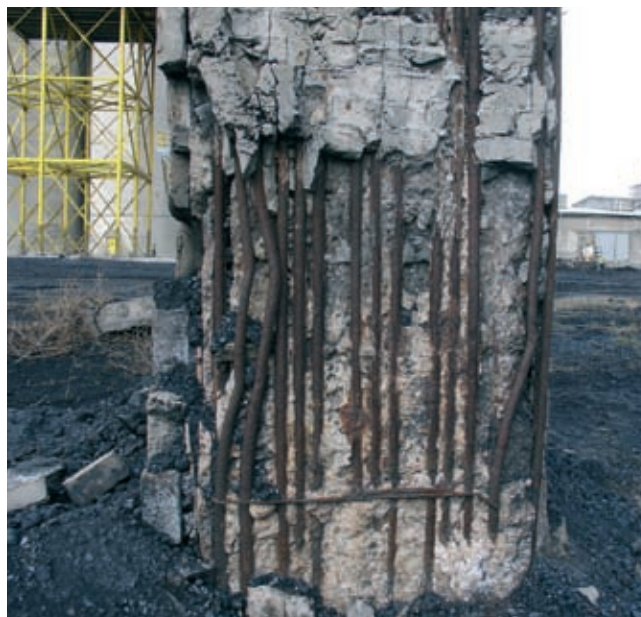
Rys. 3. Rozległe uszkodzenia betonu oraz prętów zbrojenia słupa w składzie węgla – widoczne połączenia prętów na zakład
