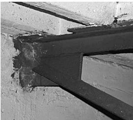
Rys. 4. Węzeł podporowy płatwi „zakotwiony” w nadbetonie
