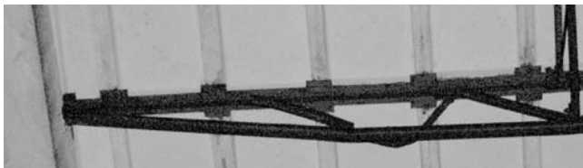
Rys. 1. Widok na uszkodzoną płatwie kratową nawy bocznej dachu
