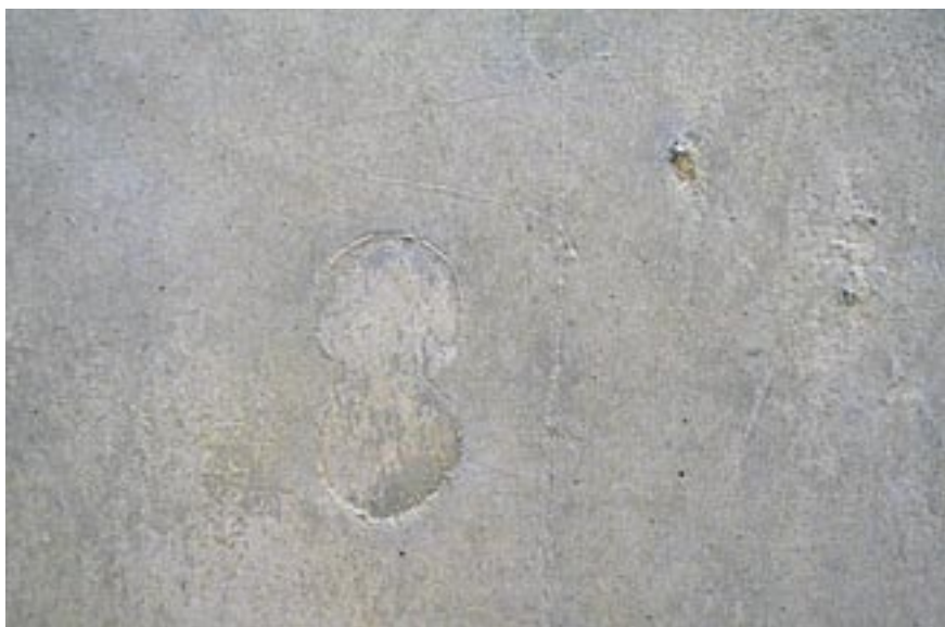
Fot. 9. Zastosowanie niesprawnych deskowań do wykonania betonu architektonicznego. Widoczne odcicia elementów, które są niepożądane dla uzyskania jednolitej gładkiej powierzchni
