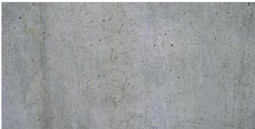
Fot. 8. Struktura betonu architektonicznego z widoczną siecią pęknięć skurczowych, spowodowanych brakiem właściwej pielęgnacji (utrzymaniem właściwych warunków ciepłno-wilgotnościowych)
