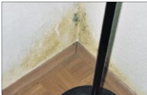
Fot. 1. Przykład zawilgocenia części cokołowej budynku
