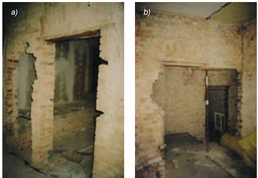
Rys. 1. Przykłady niewłaściwego wykonania a) i zabezpieczenia poszerzonego otworu drzwiowego b)
